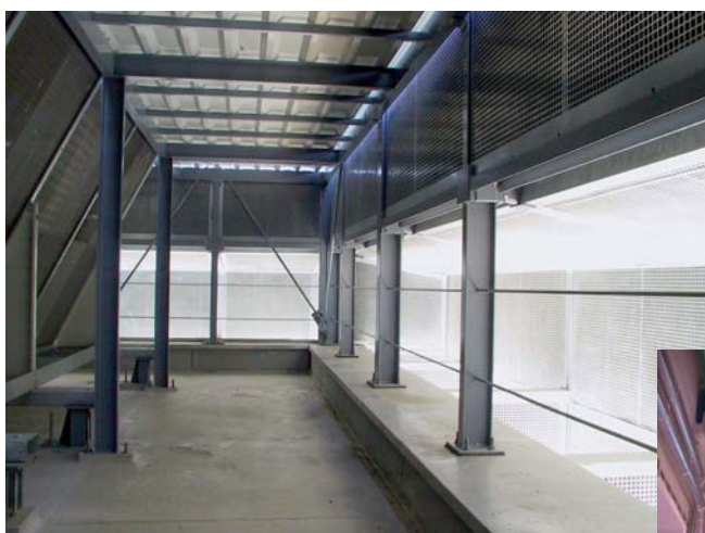
Hangszigetelő fal a tetőn a légbeszívó nyílással a légkondicionálóknál
