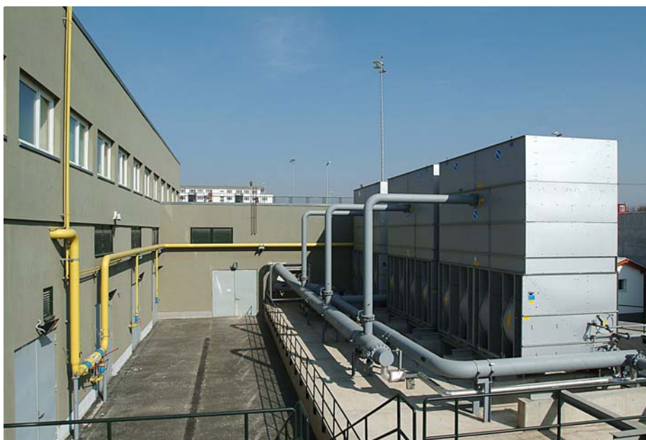
Az energiaközpont épülete a kültéri hűtőtornyokkal
